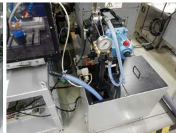
水循環機タンク(100ℓ)
