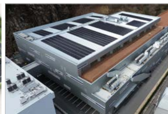
太陽光パネル(M1棟)
