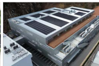
太陽光パネル(M1棟)
